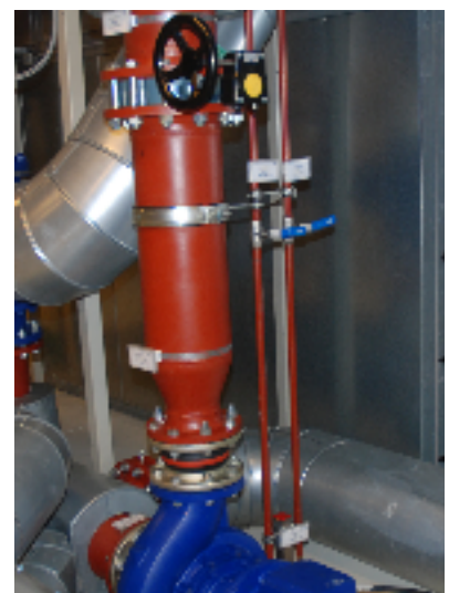
Figuur 2 pomp met cavitatie
